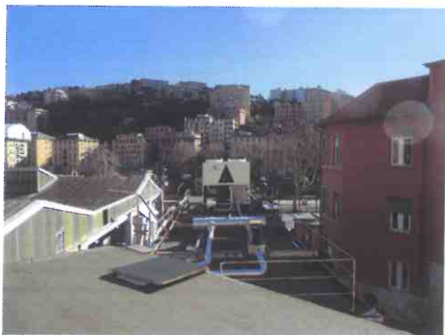
Foto 14 – S1 – Impianto climatizzazione copertura ITE.
