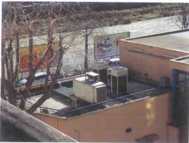
Foto 18 – S3 – Impianto climatizzazione CCB.
