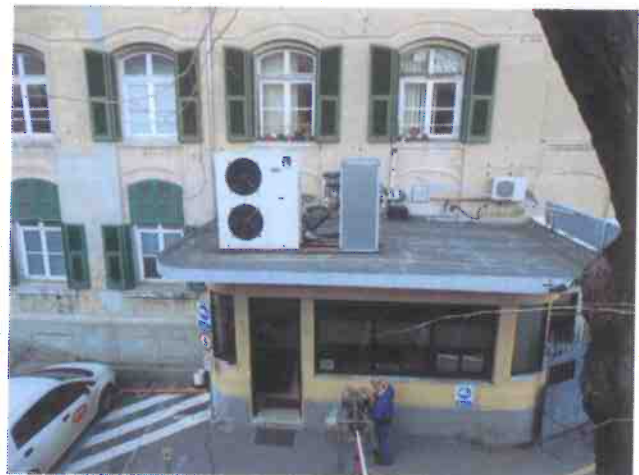
Foto 19 - S4 – Climatizzatore copertura locale guardiani.
