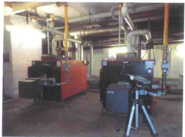
Foto 21 - S5 – Centrale termica.
