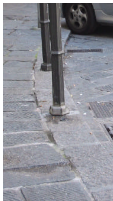
Installazione su cordolo di pietra anziché sulla congiunzione tra cordolo e marciapiede.
