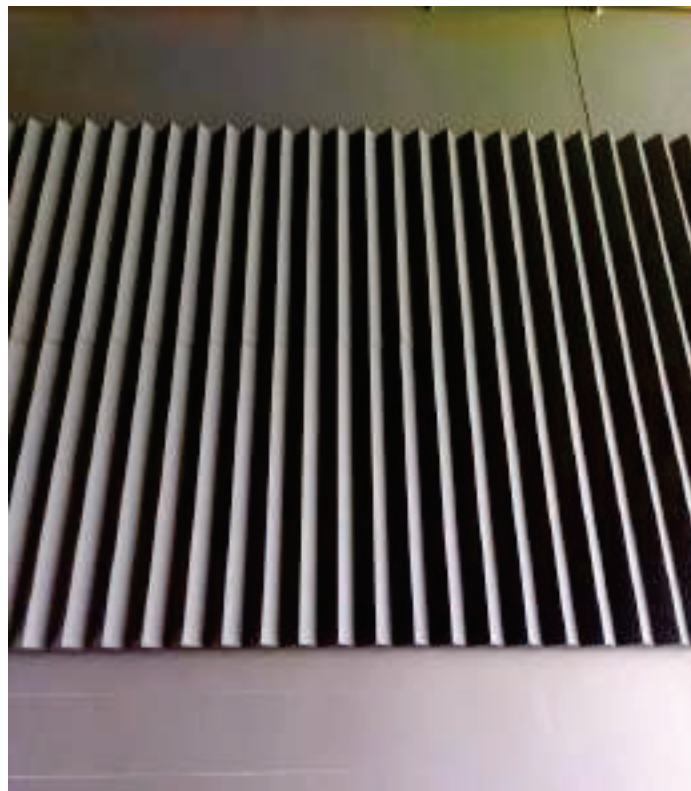
Immagine 1 – Pannelli fonoassorbenti cuneoidali rivestiti in tessuto installati nell'Auditorium del CERN - Ginevra
