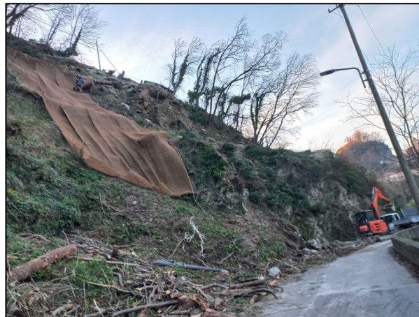
Figura 17: giovedì 11 gennaio. Al piede continuano le operazioni di sgombero e pulizia. Alle ore 13.00 è stata ripristinata la circolazione a senso unico alternato con impianto semaforico.
