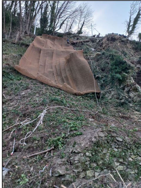
Figura 16: giovedì 11 gennaio. In corso la stesa delle reti metalliche in parete. Al piede continuano le operazioni di sgombero e pulizia. Alle ore 13.00 è stata ripristinata la circolazione a senso unico alternato con impianto semaforico.
