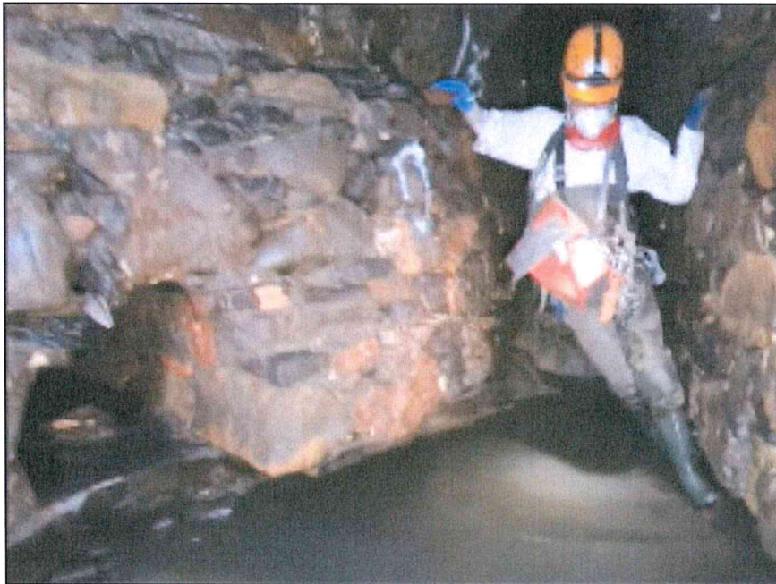
Foto 3 – parziale sgrottamento in corrispondenza delle fondazioni dell'edificio civ. 11 di Corso Dogali
