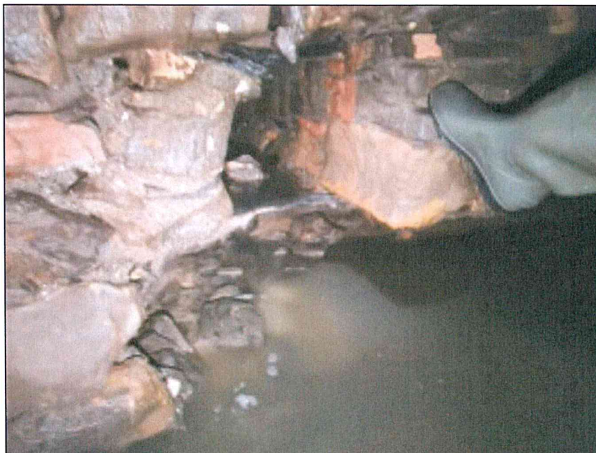
Foto 4 – particolare parziale sgrottamento in corrispondenza delle fondazioni dell'edificio civ. 11 di Corso Dogali
