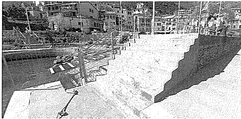
Foto 4 –dettaglio della pavimentazione della piazzola e scale di testata da riprofilare
