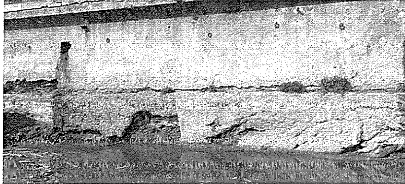
Foto 5 - dettaglio del muro di via Caboto con le infiltrazioni
