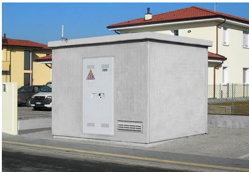
Figura 27 - Cabina elettrica di distribuzione
