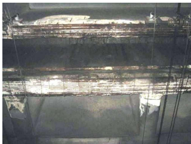
Fincantieri S.p.a. -R.F.I. - Cantiere di Sestri Ponente: ripristino e manutenzione straordinaria galleria artificiale RFI: dettaglio situazione di degrado travi di copertura in c.a. (zona di giunto)
