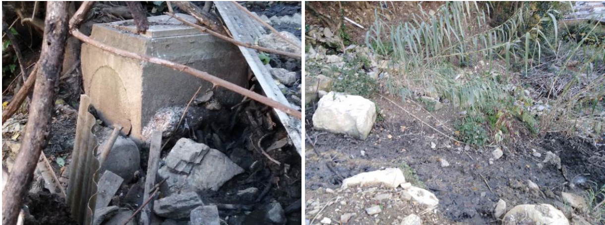
Foto 8 - Foto 9: a sx pozzetti otturati o "esplosi"; a dx il conseguente sversamento di liquami in scarpata.
