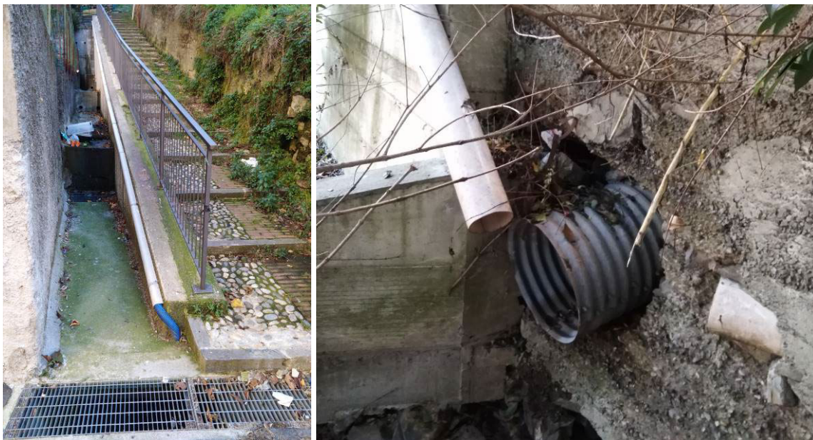
Foto 2 - Foto 3: a sinistra rio Famejano, incanalato in adiacenza all'omonima "mattonata", a monte di Via Terpi; a destra l'uscita della tombinatura in corrispondenza del Civ. 18a , presso la sommità della scarpata oltre a tubazioni secondarie derivanti dai pluviali e drenaggi a tergo delle opere di sostegno.
