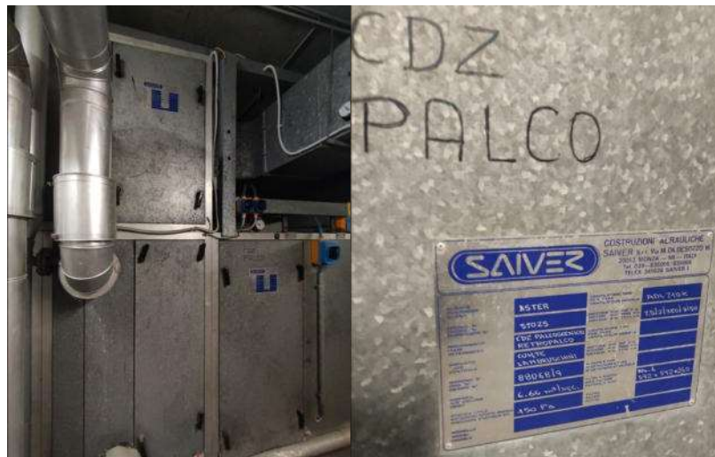
Figura 14 c – Vista UTA in previsione di sostituzione
