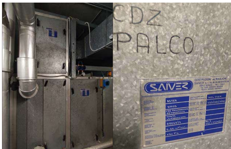
Figura 14 c-Vista UTA in previsione di sostituzione/ammodernamento
