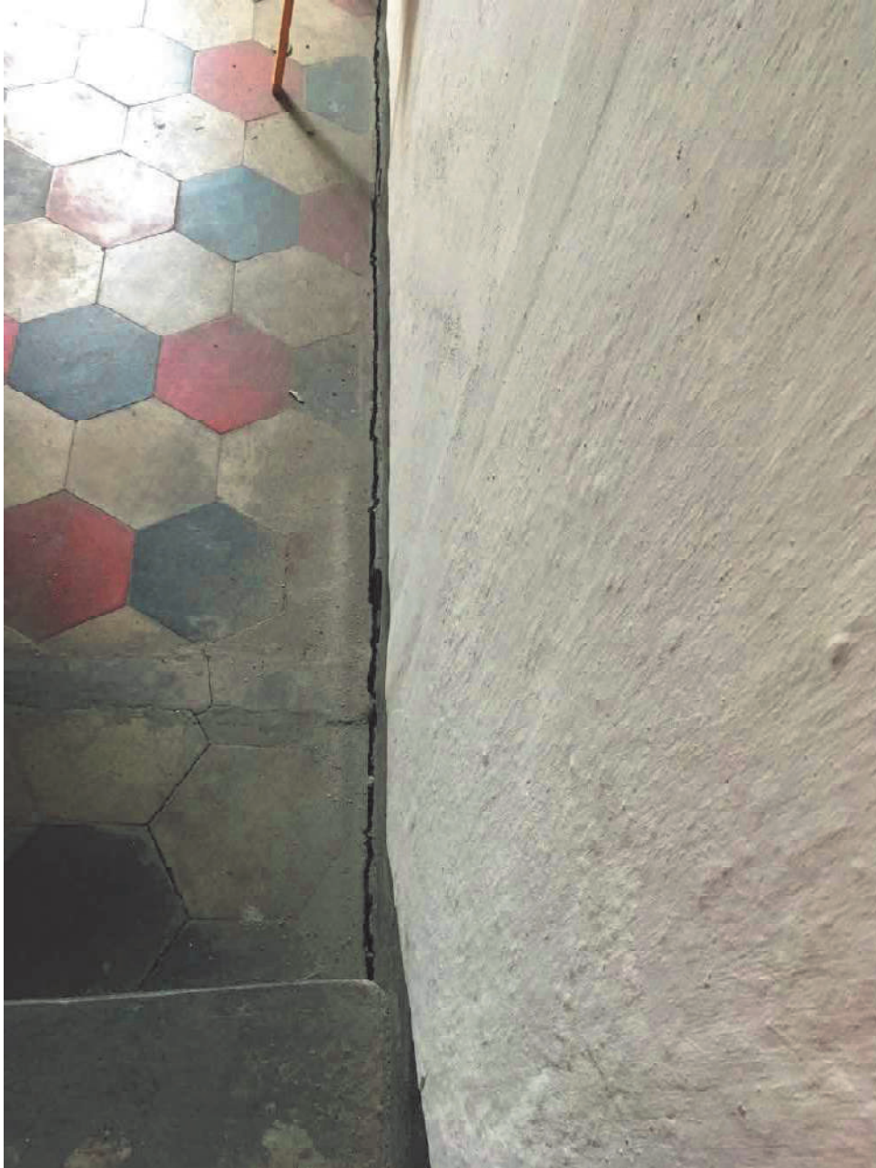
Img. 22 – IMG_6185: piano sottotetto, locale sovrastante il salone nobile, sconnessione del pavimento
