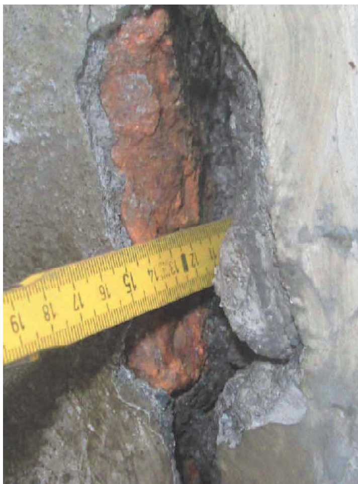
Imgg. 4 – DSC_0032: ampia e profonda fessurazione nell'angolo sud-est. Sono visibili mattoni di riempimento, forse frutto di un intervento di rifacimento.
