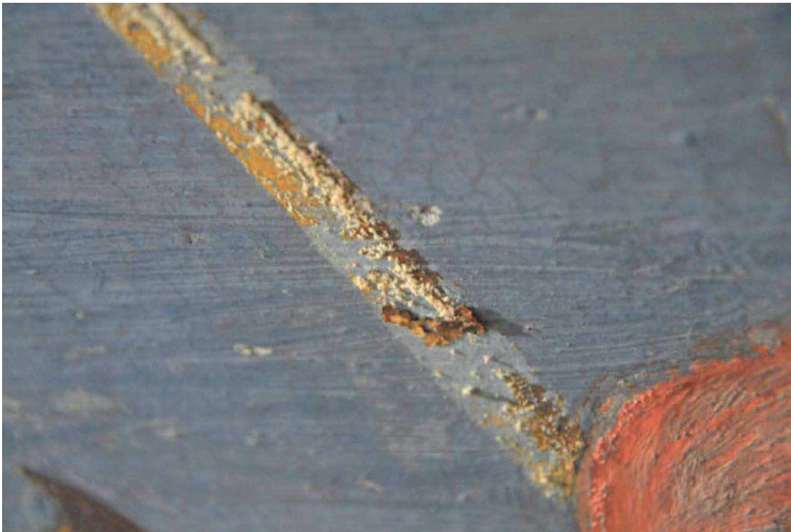
Img. 19 – DSC_0731: specchiatura ovest, efflorescenze saline, distacco della coloritura e lacuna.
