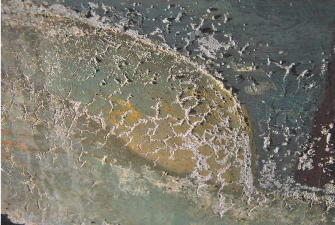
Img. 14 – DSC_0605: efflorescenze in corrispondenza della crettatura.
