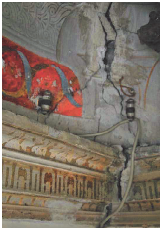
Img. 7 – DSC_0871: angolo nord-ovest, ampia fessurazione che dalla volta prosegue nel cornicione e poi lungo la parete
