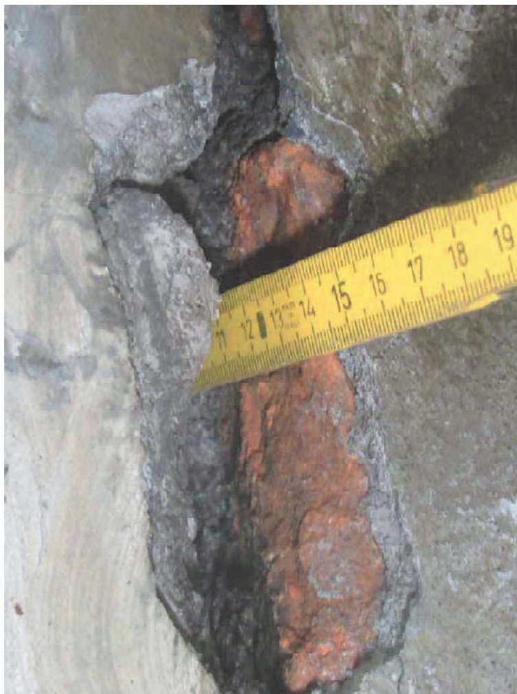
Img. 19 – IMG_0032: angolo sud-est, riempimento in mattoni, visibile dalla fessurazione verticale dell'ovale
