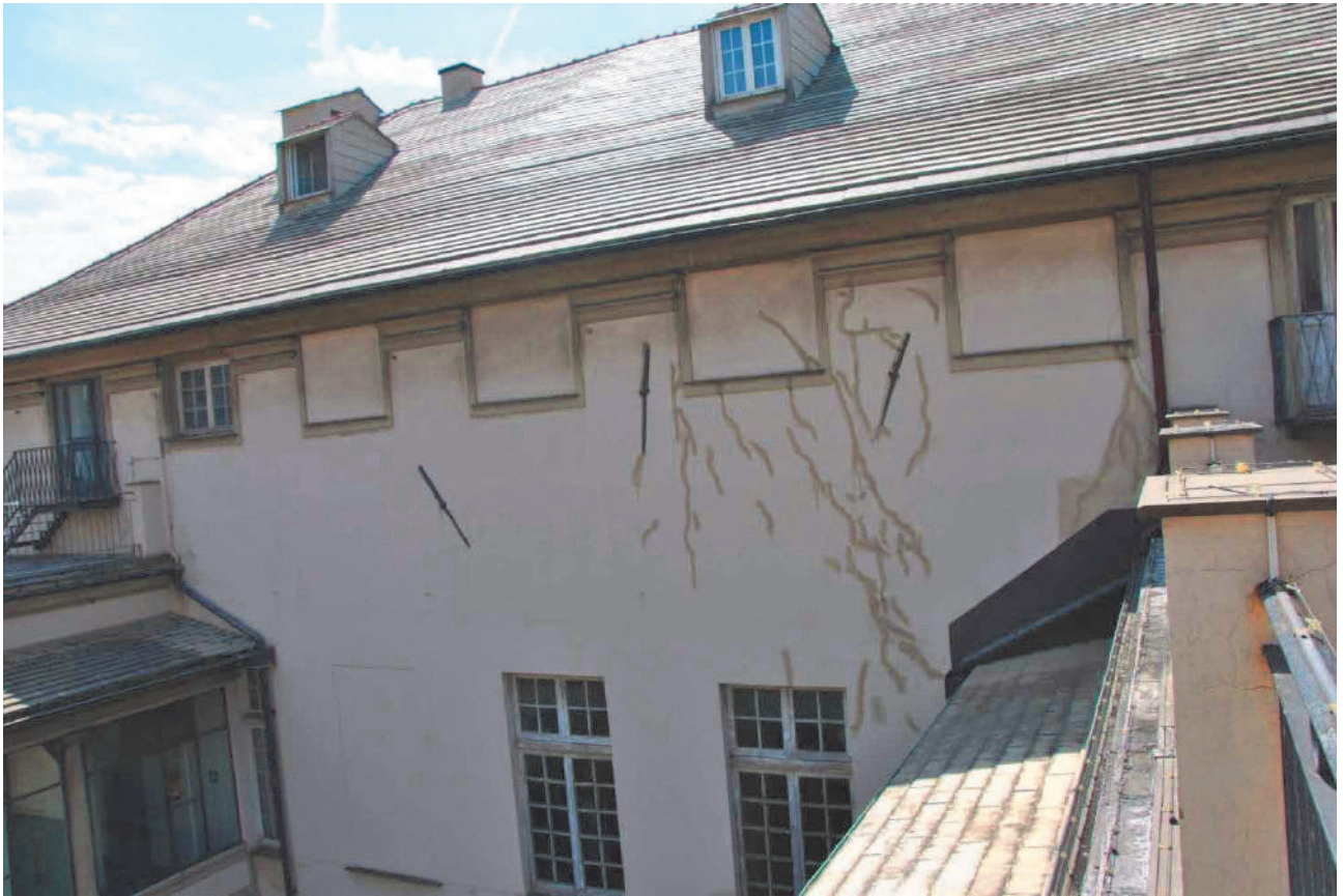
Img. 8 – DSC_0885: fronte esterno nord, sono visibili 4 bolzoni capochiave delle catene e numerose stuccature.
