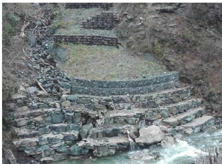
Figura 4– Cedimento della parte centrale della scogliera
