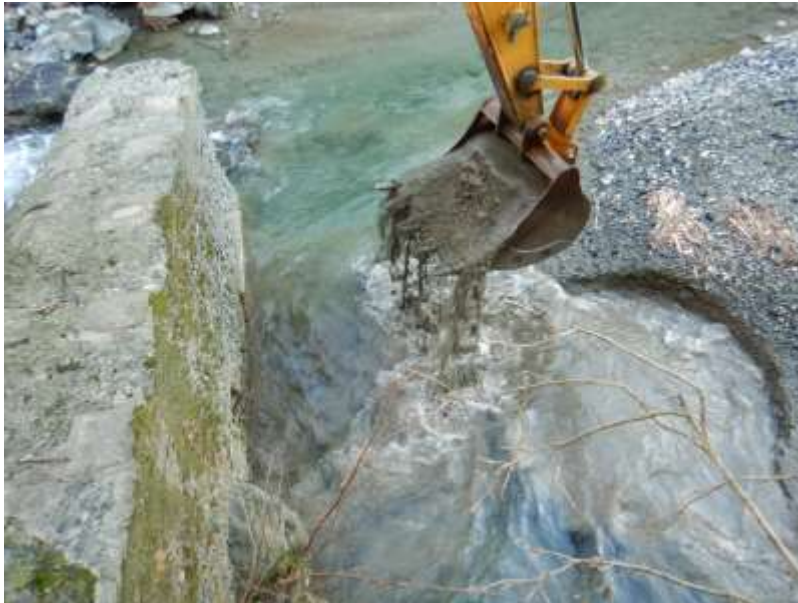
Foto 4 – Saggio geognostico diretto eseguito ai piedi della briglia di valle (sulla sinistra della foto si nota il moncone ancora in piedi).
