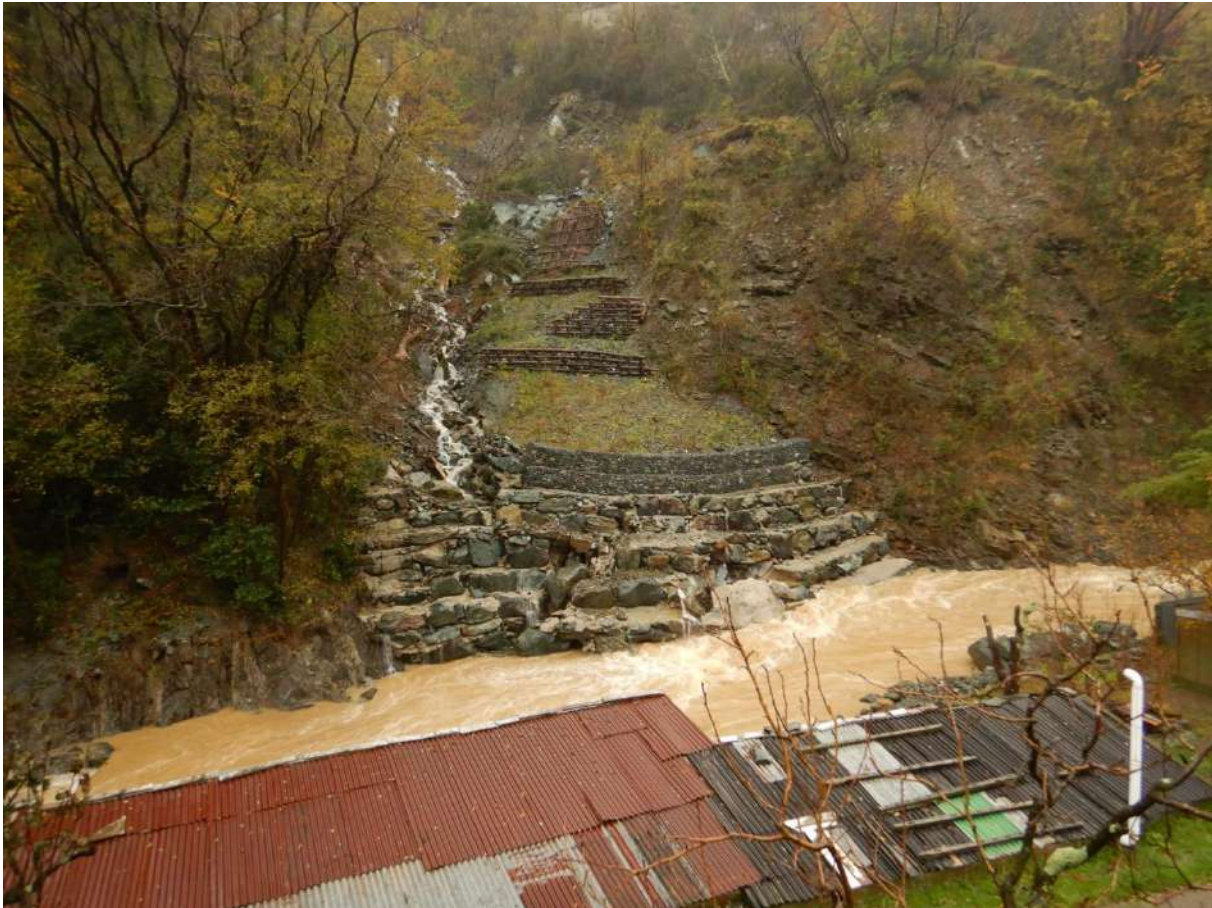
Foto 1 –scogliera visibilmente disarticolata e danneggiata dall’azione erosiva del corso d’acqua
