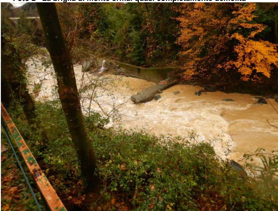
Foto 3 –La briglia di valle anch'essa quasi completamente demolita
