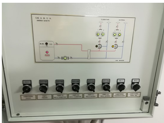
Figura 4.8 - Particolare del pannello di controllo di dell'impianto termico
