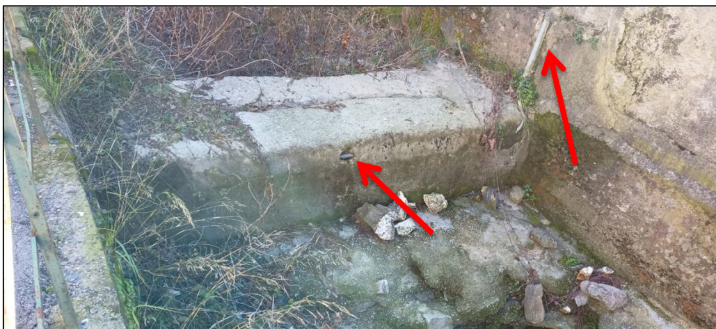
Interferenza reti di telecomunicazione con la briglia a monte
