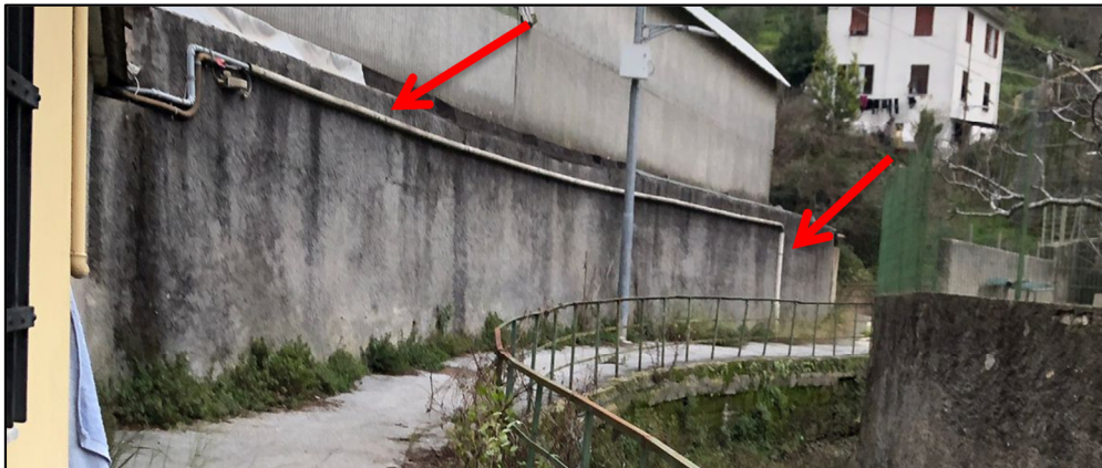
Interferenza reti di telecomunicazione con la briglia a monte (lungo via Rio Fulle)
