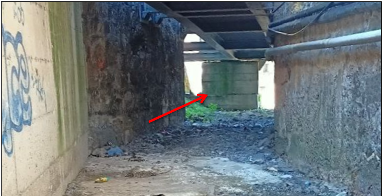
FOTO 5 - Tratto a valle – Sottopasso ferroviario, zona indicata in fascia A di inondabilità. Pilone della passerella pedonale sul torrente Polcevera.
