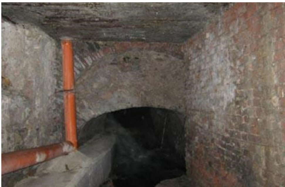
Esempio di sezione della Roggia dei Mulini - Si evidenzia la presenza del bauletto della rete fognaria
