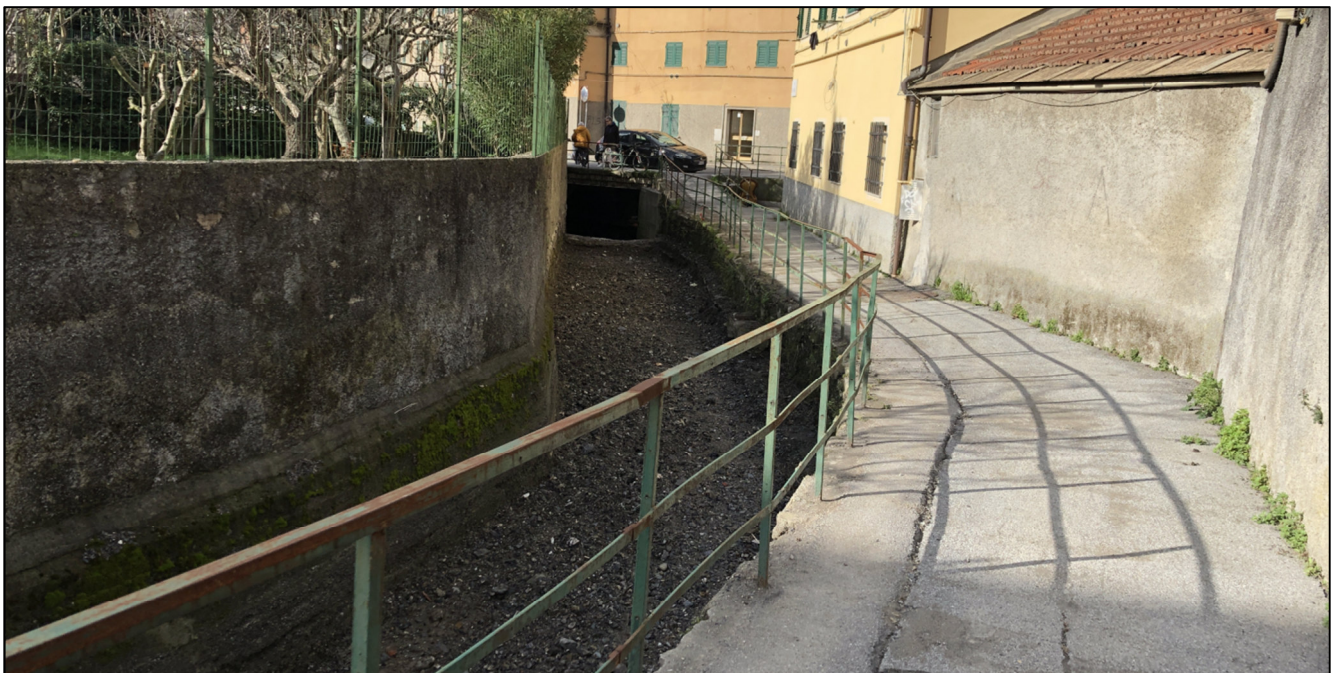
FOTO 3 - Tratto a monte – Passerella pedonale e tratto adiacente a via Rio Fulle, zona indicata in fascia A di inondabilità. Imbocco della tombinatura
