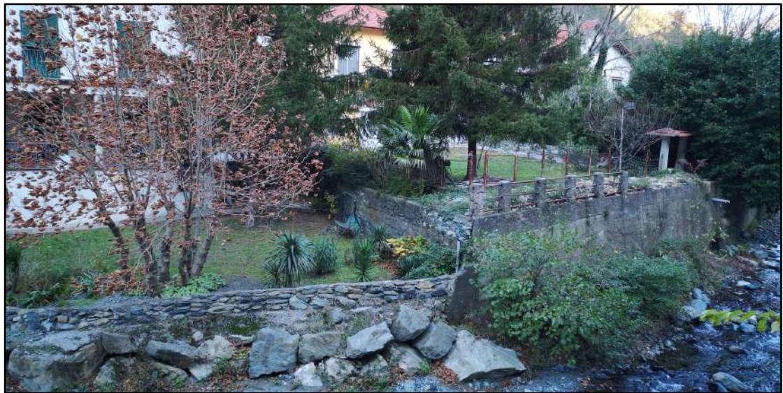
Foto n. 3 ove si rappresenta il muro da demolire della sponda destra ove è presente una tubazione gas interrata a distanza di circa 1 m dalla testa muro.
