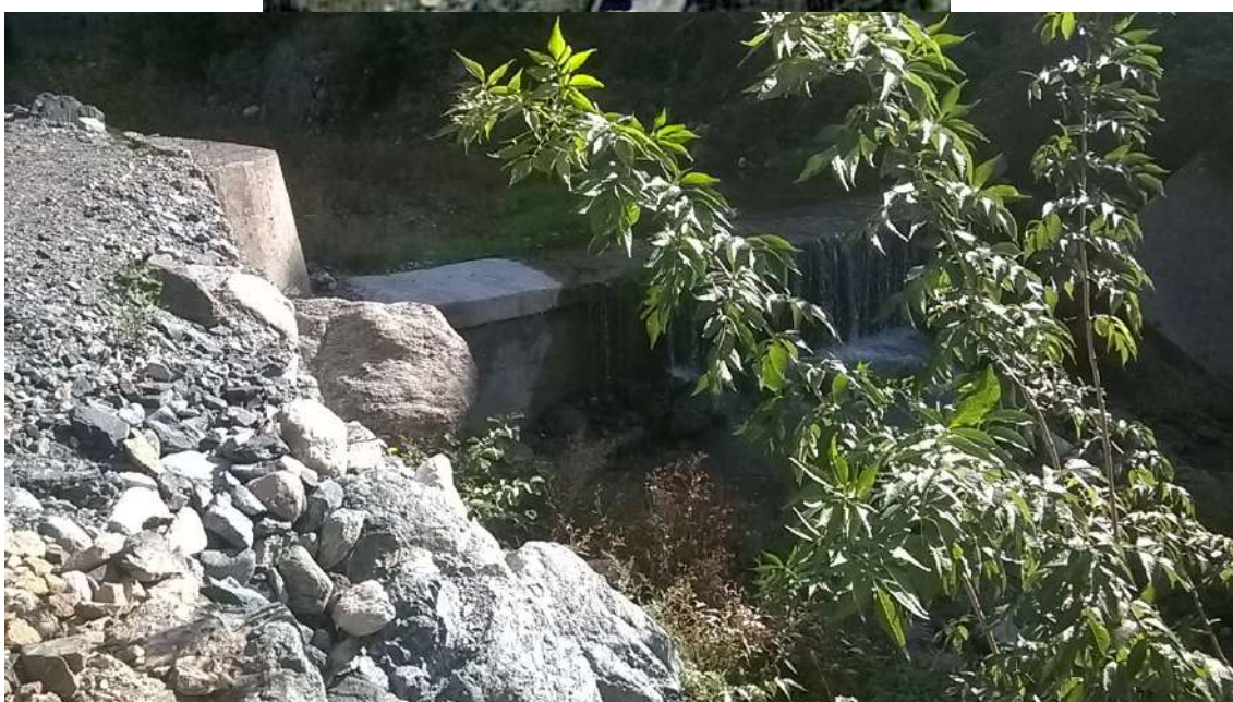
briglia posta a valle dell'abitato e termine del tratto di torrente in esame
