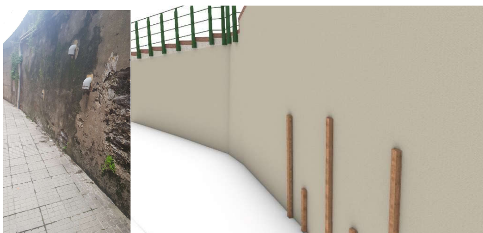
Figura n. 5 - Stato attuale del muro a valle della fermata Centurione (si notano i barbacani ripiegati verso il basso al fine di evitare lo sgorgo di acqua in pressione nel cortile) e stato di progetto del muro di Centurione tratto da un rendering 3D presente in allegato
