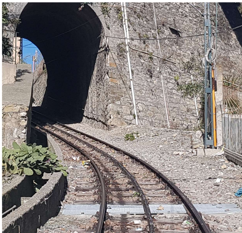
Figura n. 25 - Dettaglio dell'area all'uscita del tunnel al disotto della via Bari, posto ora in stato di semi-abbandono
