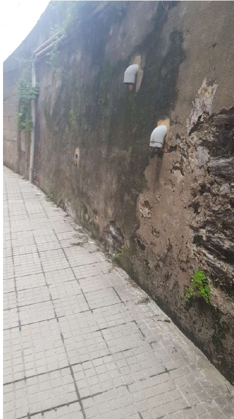
Figura n. 5 -Stato attuale del muro a valle della fermata Centurione (si notano i barbacani ripiegati verso il basso al fine di evitare lo sgorgo di acqua in pressione nel cortile)
