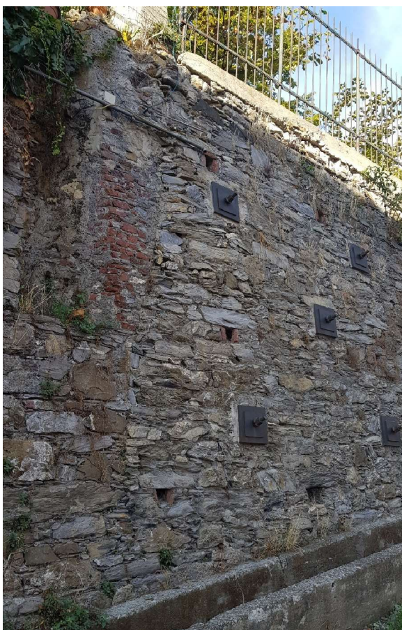
Figura n. 32 -Intervento già presente e che mostra il risultato visivo atteso anche per i tratti di nuova progettazione
