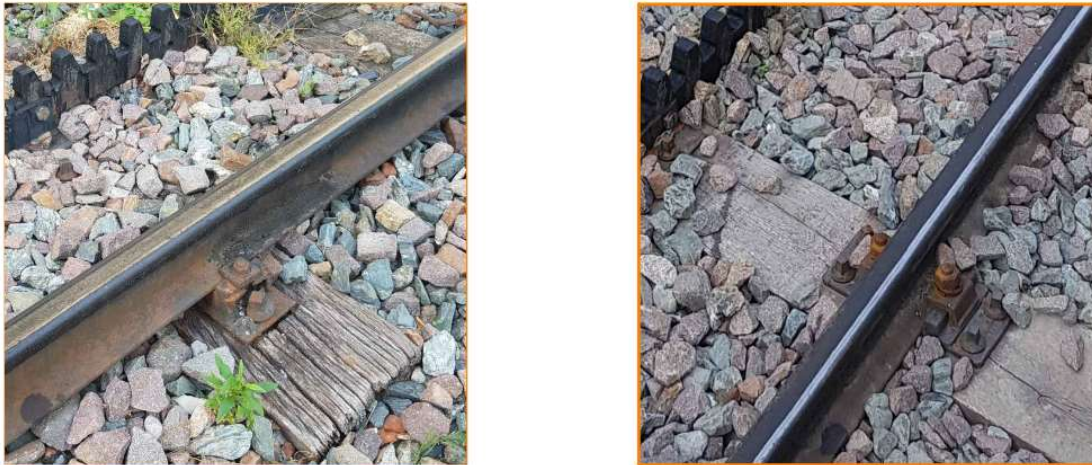
Figura n. 29 -Un esempio di traversina ammalorata sulla linea ed una recentemente oggetto di sostituzione
