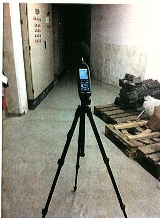
Figura 7 – Postazione di misura 7 (all'interno al piano seminterrato, nei locali tecnici )
